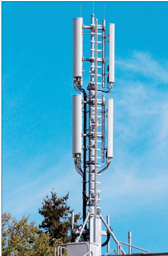
Die Mobilfunkanlage an der Felix-Hölzl-Straße.
